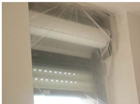
Figure 5 : Protection d'une menuiserie
